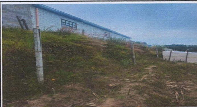
Foto 3: Salones de clases corren riesgo por estar contruidos en área de relleno y sin muro de contención.
