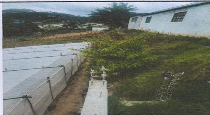
Foto 1: Parte superior del área que no cuenta con muro.
