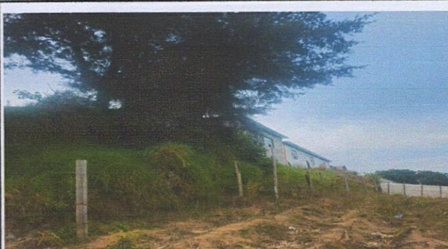
Foto 4: Parte inferiores del área que no cuenta con muro de contención
