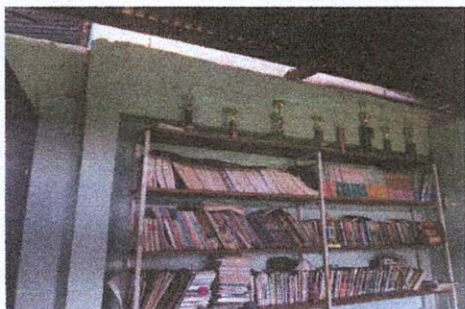
Foto 1: en la imagen se puede observar que la lámina de la biblioteca no está bien colocado y en épocas de lluvia entra el agua
