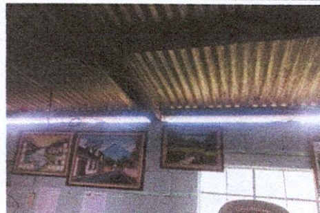
Foto 4: la fotografía evidencia el la falta de cielo falso para evitar encontrar mojado el lugar
