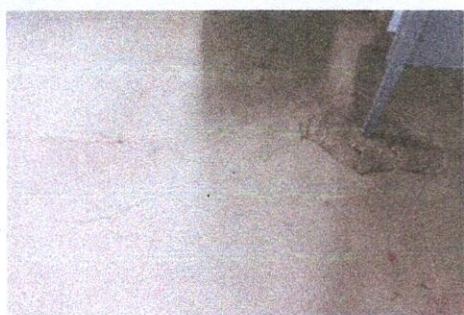
Foto 5: la imagen evidencia el piso en mal estado
