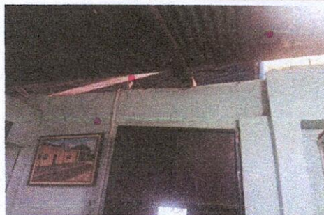
Foto 2: en la fotografía se puede observar los espacios en donde el agua se filtra lo cual hace que los libros se mojen
