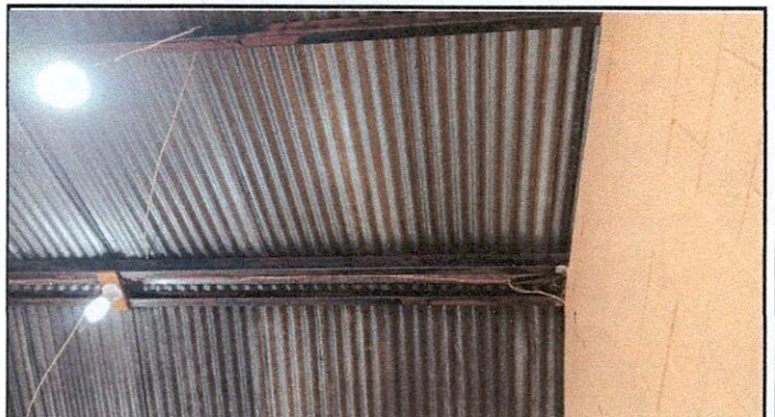
Foto 4: Es urgente mejorar los cables eléctricos en mal estado dentro de las dependencias del centro educativo.
