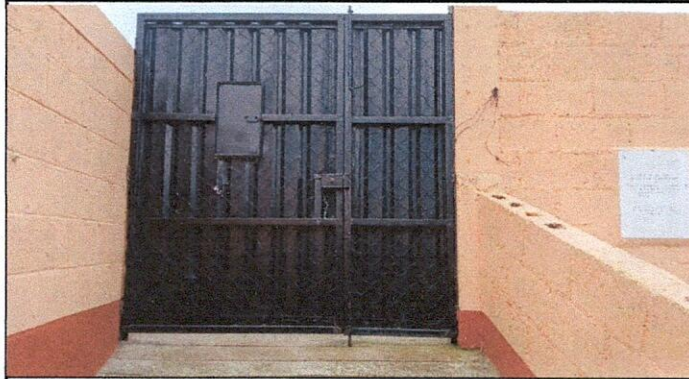
Foto1: mejorar la puerta para la seguridad de la escuela.
