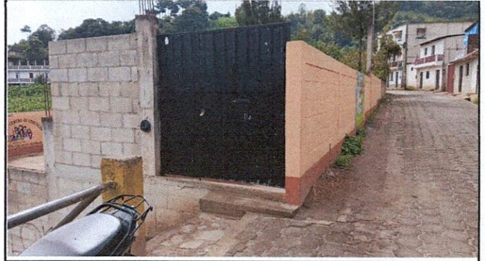
Foto 2: Necesitamos la sustitución de la puerta ya que tiene desperfectos.
