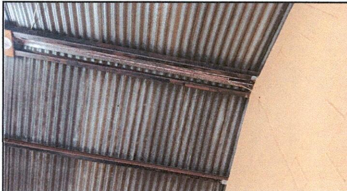
Foto 3: Es necesario mejorar la iluminación eléctrica.
