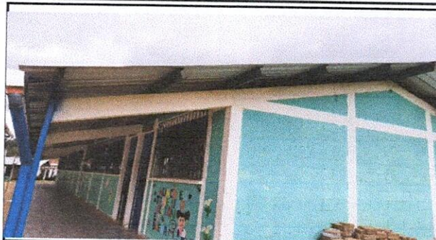
Foto 2: Existe la necesidad de cambiar las laminas de de las tres aulas, corredor y direccion.
