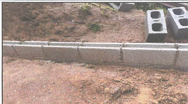
Foto 2: Muro perimetral a remozar.
