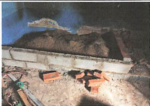
Foto 1: Mantenimiento a estufa rural.
