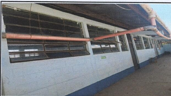
Foto 4: Cambio de techado para tres salones de clases, actualmente las láminas ya se encuentran muy oxidadas y deterioradas.
