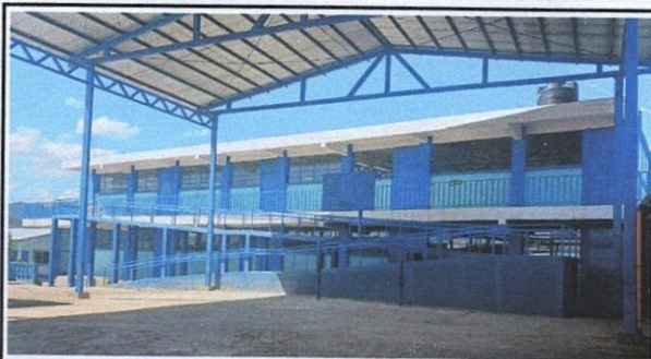
Foto 3: Actualmente la rampa para acceder al segundo piso está deshabilitada para los estudiantes debido al peligro que representa.
