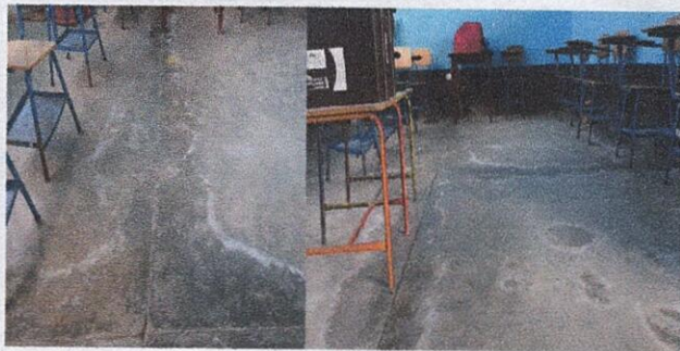
Foto 1: El piso de los salones, dirección y baños se encuentra muy deteriorado debido al paso de los años, se necesita cambio del mismo para tener buena presentación e instalaciones educativas de calidad.
