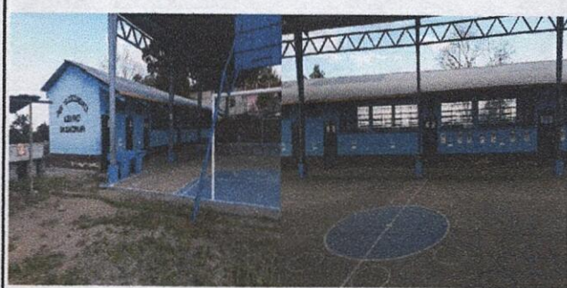
Foto 2: La carencia de canales formales provocan que los alumnos resbalen y se mojen al dirigirse hacia los diferentes ambientes del establecimiento durante y después de las constantes lluvias del invierno.
