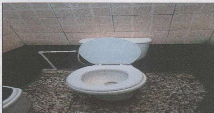
FOTO 8 SERVICIO SANITARIO Y ACCESORIOS
