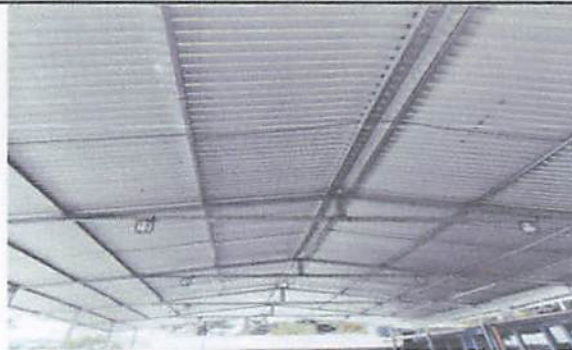
Foto 2: ya realizado el cambio de iluminacion para nuestra cancha
