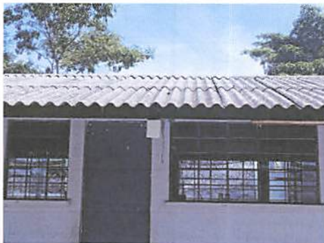
Foto 3: Necesidad de remozamiento para el techo, y pintado de nuestra escuela
