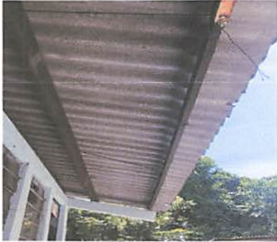
Foto1: Necesidad de remozamiento para el techo
