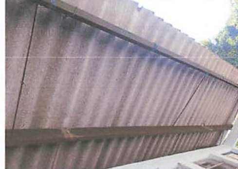
Foto 2: Necesidad de remozamiento para el techo
