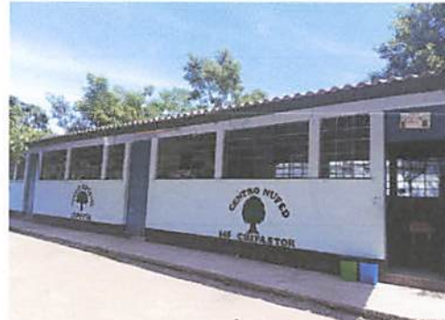
Foto 4: Necesidad de remozamiento para el techo
