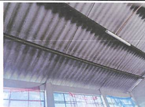
Foto 6: Necesidad de remozamiento para el techo
