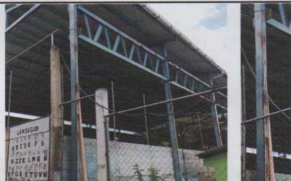
Foto 3: PINTURA DE PARTE OXIDADA DE ESTRUCTURA DE CANCHA
