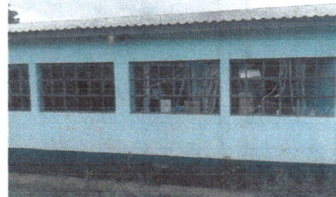
Foto 4: Se necesitan Balcones en el módulo No. 2
