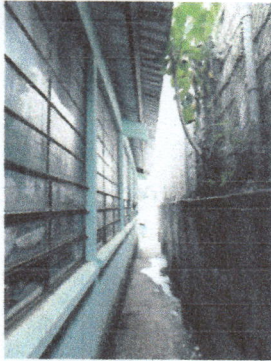
Foto 1: Daño por faltas de canales.
