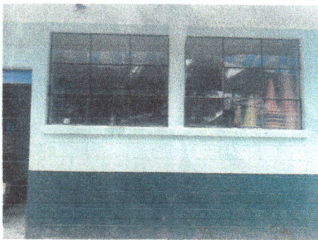
Foto 3: Se necesitan balcones en el módulo 1
