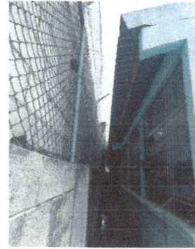
Foto 2: Se necesitan instalación de canales.
