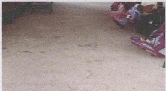
Foto 1: Sustrucción de piso aula 3
