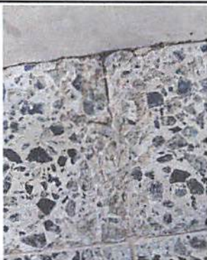
Foto 3: Piso en mal estado
