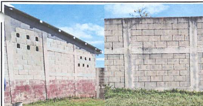
Foto 5: Pintura en mal estado
