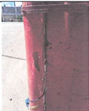
Foto 7: Deterioro de bajantes de aguas pluviales
