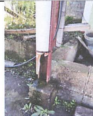
Foto 8: Deterioro de bajantes de aguas pluviales
