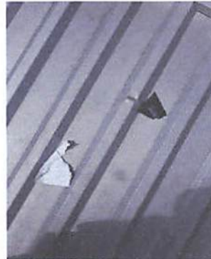
Foto 2: Lámina en mal estado
