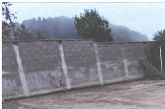
Foto 6: Pintura en mal estado
