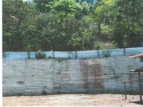
Foto 2: En esta foto se evidencia la necesidad de aumentar la altura de la pared con 3 hiladas de block, fundición de columnas y colocación de mallas, para evitar algún accidente con los niños.
