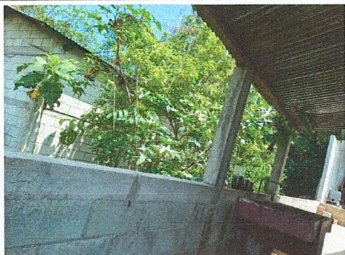
Foto 3: En el lado izquierdo, es necesario continuar con la pared aumentando la altura de 5 hiladas de block, con malla, en la parte exterior del establecimiento pasa un desagüe que corresponde al terreno del colindante, donde se desvía el agua.
