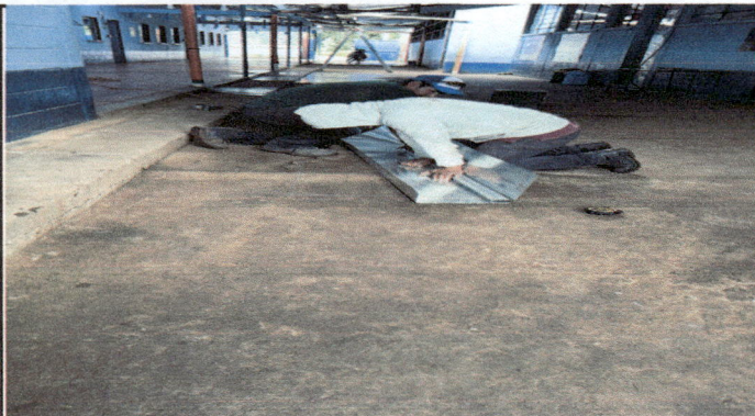
Foto 3: Cambio de canales por agrietamiento en todo el sector.
