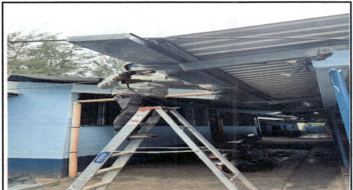
Foto 4: Cambio de canales por agrietamiento en todo el sector.
