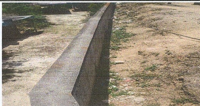
Foto 2: muro perimetral desalineado
