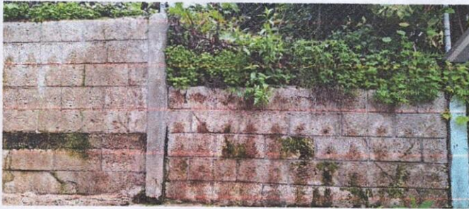
Foto 1: Se necesita con urgencia un muro de contención debido al peligro que representa para la comunidad educativa.
