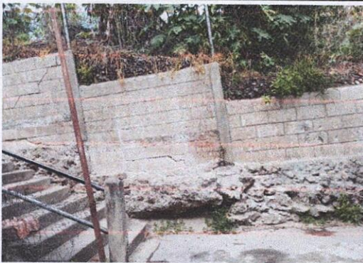
Foto 3: el actual muro esta por caer debido al peso que se encuentra al otro lado por lo que se necesita la sustitución de un nuevo muro de piedra para mejor estabilidad.
