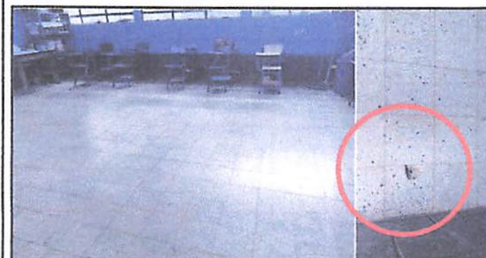
Foto 3: agujeros y grietas en aula de cuarto primaria
