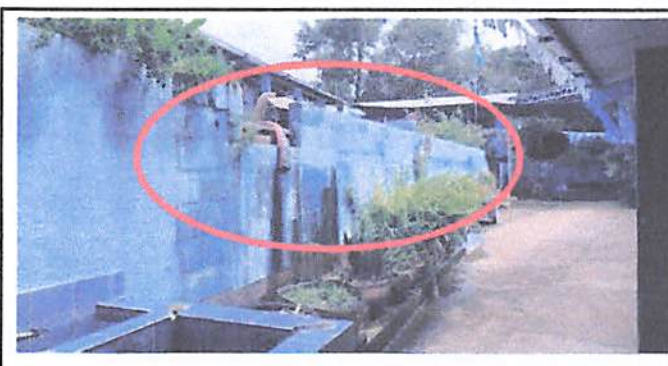
Foto 6: pintura deteriorada en muro de contención
