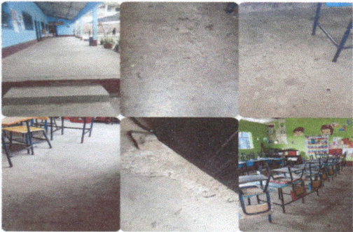
Foto1: instalacion de piso ceramico en salones y corredor del establecimiento, se evidencia el mal estado de la torta de cemento con que se cuenta.
