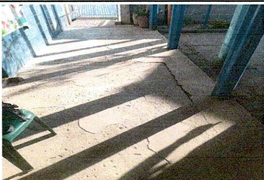
Foto 3: Se necesita completar suministro e instalación de piso.
