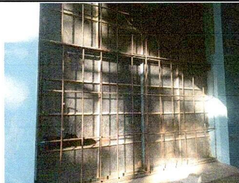
Foto 2: Se necesita cambio de vidrio y balcones.
