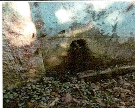
Foto 6: Se necesita reparación de drenaje de aguas grises.
