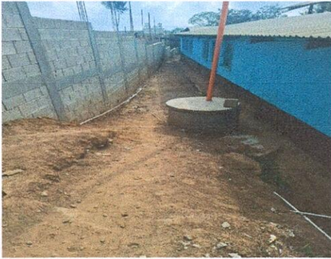
Foto1: Pavimentación del área en mal estado
