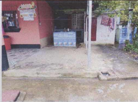
Foto 13: reparación de torta de concreto, área de pila y cocina está en mal estado
