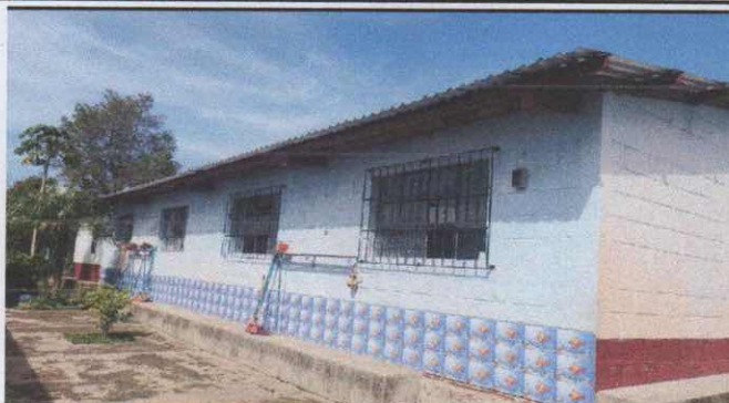
Foto 2: Canales frente a los baños y salones que les hace falta.
