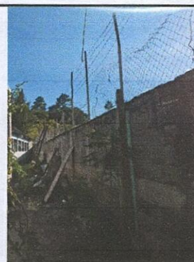
Foto 4: Parte de atrás del Establecimiento, malla dañada y muro bajo.
