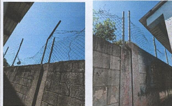
Foto 2: Muro perimetral atrás de los salones, la malla está dañada.
