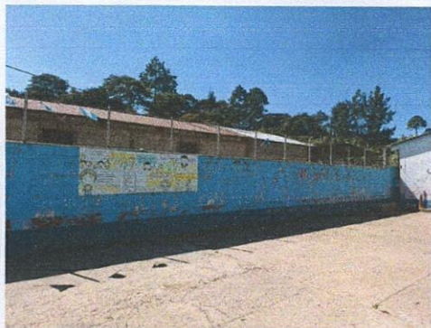
Foto 1: Muro perimetral de la entrada del Establecimiento se encuentra muy bajo, por lo mismo ha habido varios robos en el establecimiento.
