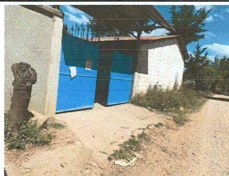
Foto 2: Sin Acera pavimentada entrada principal
