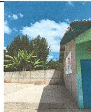
Foto 6: Sin techado en patio.
