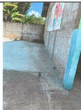
Foto 4: Sin banqueta para filtración de agua.
