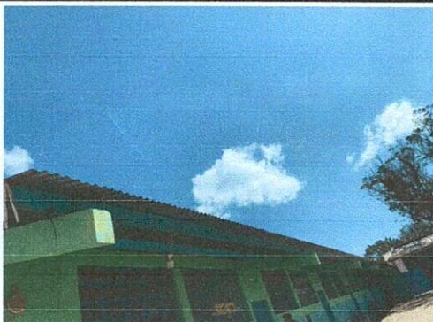
Foto 3: Sin canal ni bajada de agua.
