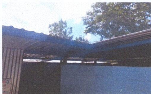
Foto 2: Levantamiento del muro por la acumulación de humo dentro de la cocina.
