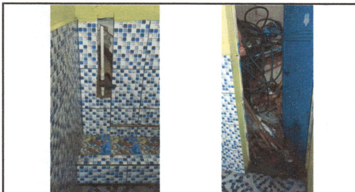
Foto 3: Reparación de drenaje que proviene de los sanitarios y tinaco, se esta saliendo el agua por daños en las tuberías, necesita reparación.
