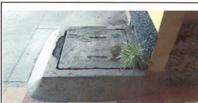
Foto 4: El cisterna esta en mal estado, no tiene acceso para realizar la limpieza en el fondo, necesita reparación para garantizar el almacenamiento del agua.
