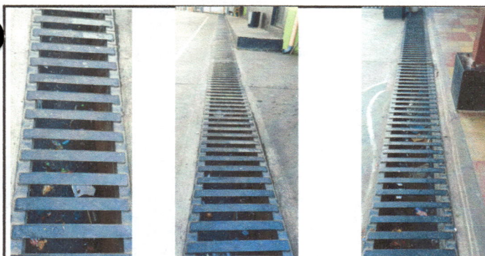
Foto 5: Las cunetas con rejillas instaladas en el patio, se encuentran sobre puestas, los niños se tropiezan al pasar, necesita reparación para evitar más incidentes.
