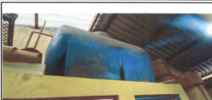
Foto 2: El tinaco presenta fuga debido a su antigüedad. No abastece la red de sanitarios, se escapa el agua por lo que es necesario cambiarlo.
