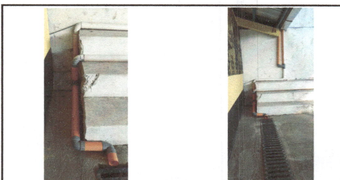
Foto 6: Las tuberías de bajadas de agua hacia el drenaje estan sobrepuestas, representa riesgo para los niños, se necesita reubicación para evitar mas incidentes.
