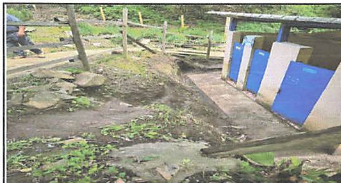
Foto 3: Es necesario levantar un muro de contención, para evitar la caída de tierra a los servicios sanitarios.
