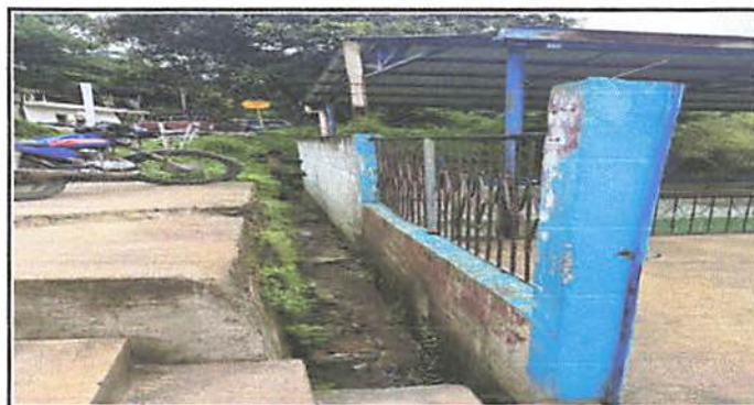
Foto 4: Es necesario continuar con el muro perimetral para cubrir la cuneta de drenaje y además, se debe fundir dicha cuneta.
