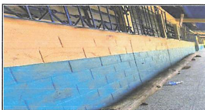
Foto 6: Se requiere pintar la parte exterior de aulas.
