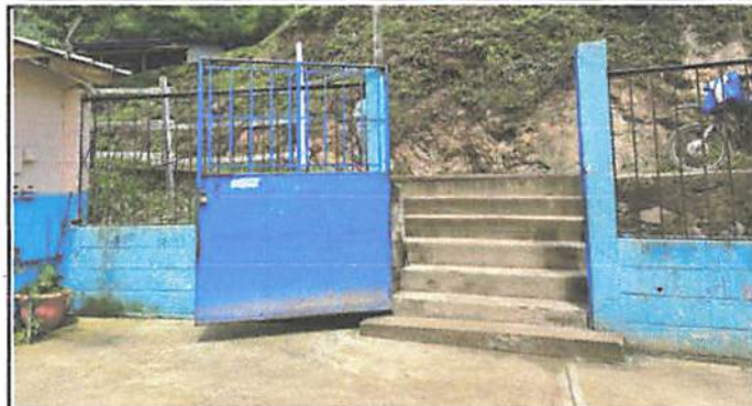
Foto 2: Entrada al establecimiento no es inclusiva, se requiere de una rampa.
