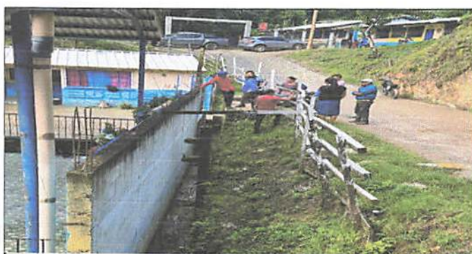
Foto 5: Cuneta de drenaje destapada en la estrada del establecimiento, se necesita cubrirla y para ello tambien, se debe continuar con el muro de contención.
