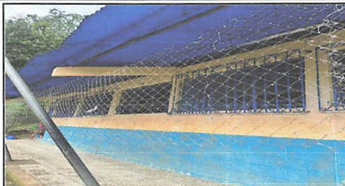
Foto 1: Malla que protege los salones de clase está deteriorada.
