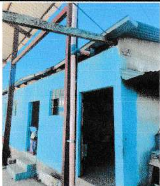
Foto 1: Canales y bajada de agua pluvial
