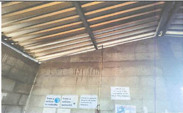
Foto 1: Tejado de cocina, por ampliación.
