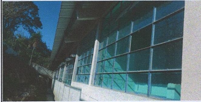
Foto 2: Es necesario la fabricación y colocación de balcones para la protección de los vidrios y cristales de la institución educativa, para evitar accidentes.
