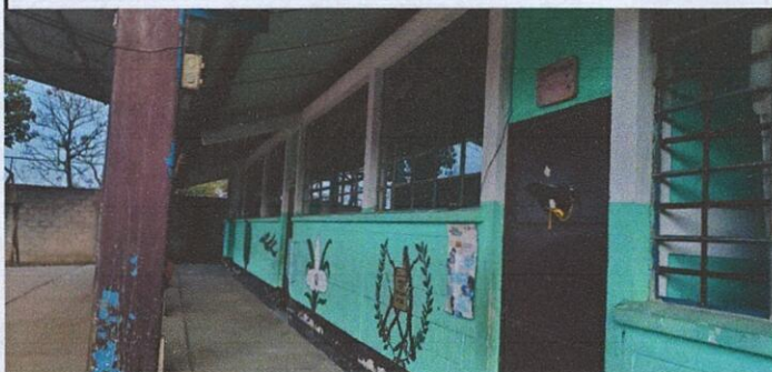
Foto 1: Es necesario remozar las paredes con repello para evitar el deterioro de la estructura del centro educativo
