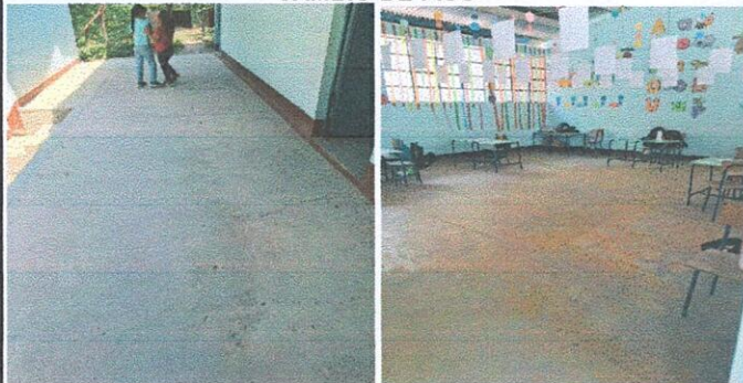
Foto1: Se cuenta con un piso deteriorado por ello se colocará piso cerámico.
