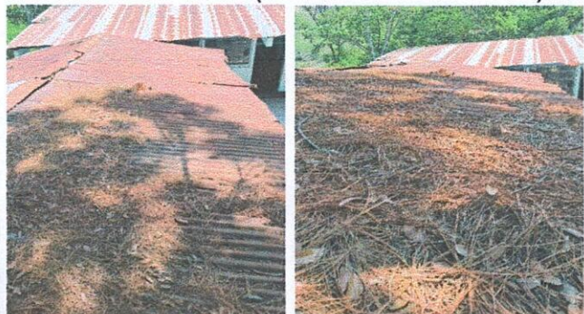
Foto 3: Techo de cocina en mal estado, se debe realizar el cambio.
