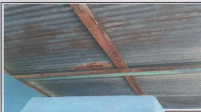
Deterioro de techo
