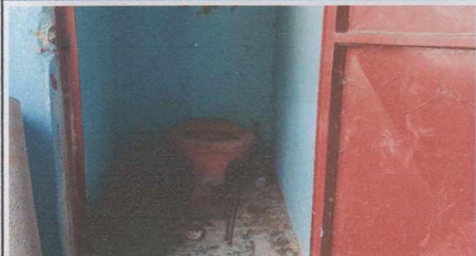
mal estado de los baños
