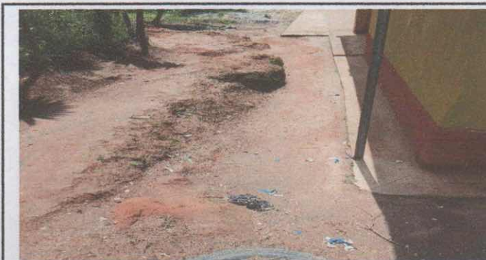
Entrada principal en mal estado
