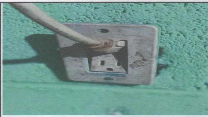
Mal estado del sistema eléctrico
