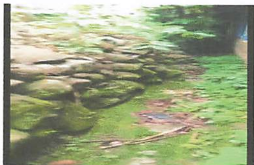
De este lado se puede observar que el muro de contención echo de piedras ya está por derumbarse
