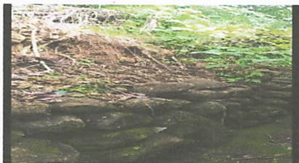
El muro de contención que está hecho con piedra ya está por derribarse
