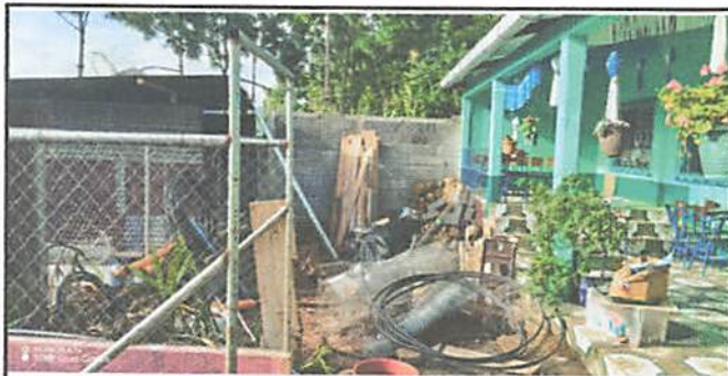
También frente a la escuela se necesita techado de 36 metros 2
