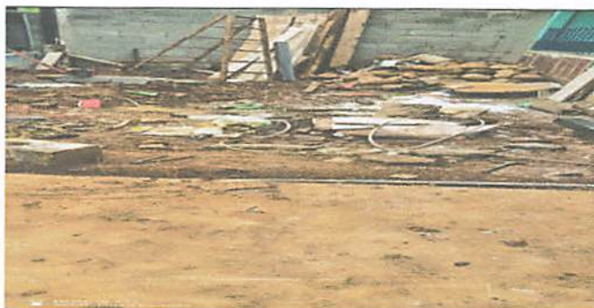
Se necesita sustituir pavimento en mal estado
