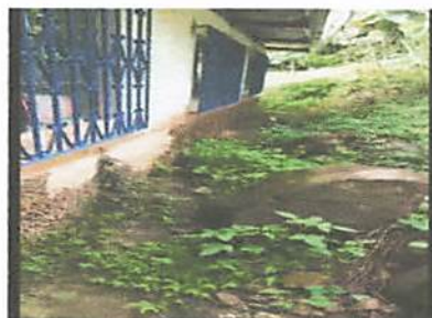
Algunas Piedras ya se aayeron y han arruinado la pared del establecimiento
