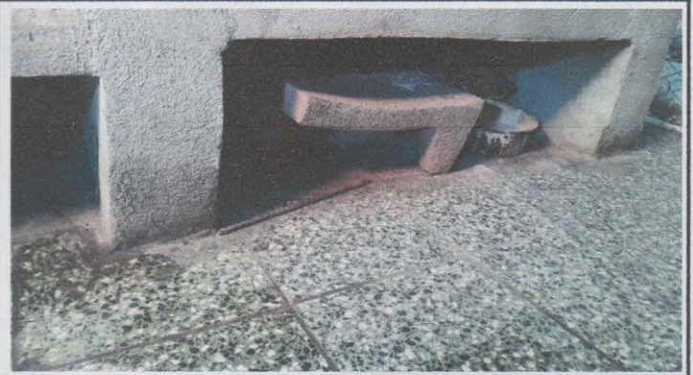
Foto 4: gabinetes en mal estado
