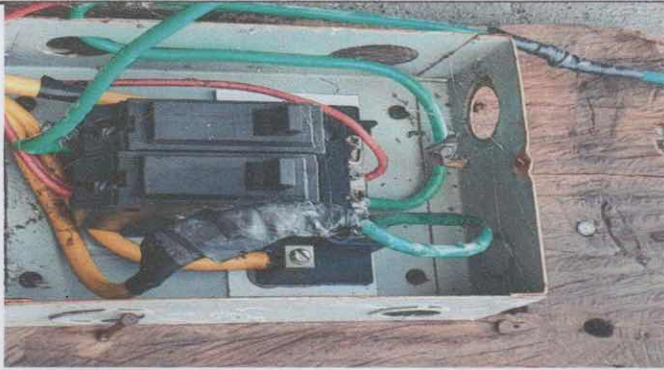
Foto 1: Tablero y de caja HR en mal estado
