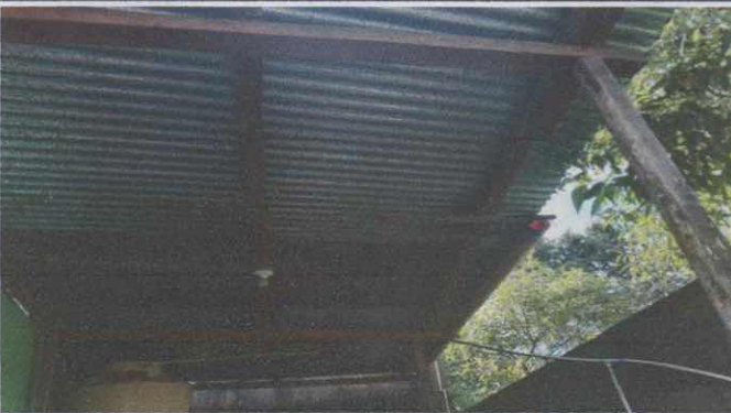
Foto 3: deterioro de estructura y techo
