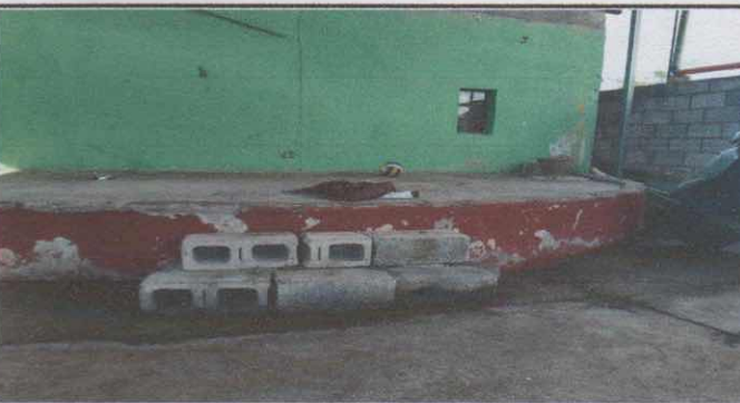
Foto 5: Mal estado de escenario
