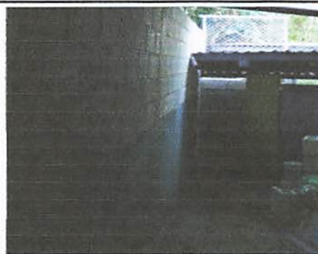
Foto 4: Reparación de paredes debido al área boscosa han ingresado animales que cuasan daño a los niños
