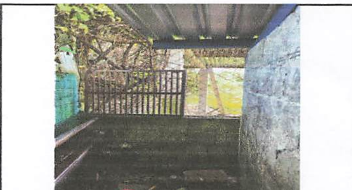
Foto 4: Reparación de paredes debido al área boscosa han ingresado animales que cuasan daño a los niños
