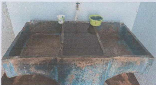
FOTO 1 : CONSTRUCCION DE PILETA POR MAL ESTADO
