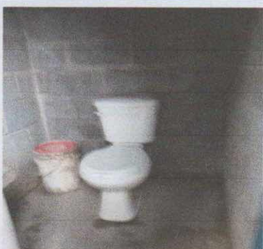
FOTO 3. CAMBIO POR MAL ESTADO
