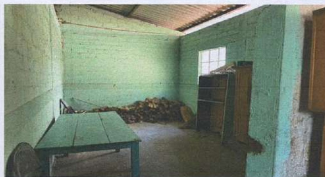
Foto 2: Piso interior de bodega en mal estado
