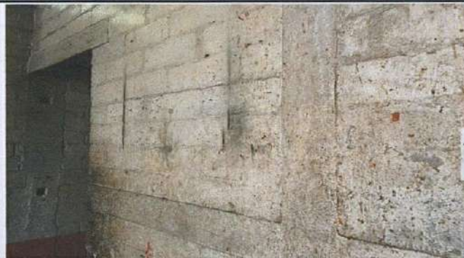
Foto 8: Paredes interiores de cocina en mal estado
