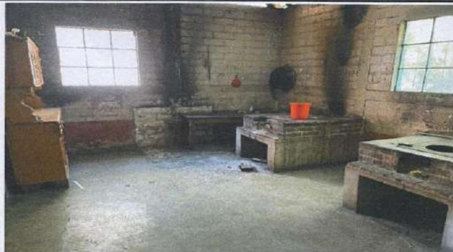
Foto 1: Piso interior de cocina en mal estado
