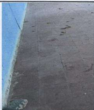
Foto 5: Piso de aulas en mal estado
