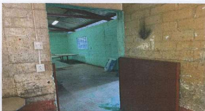
Foto 3: Piso en area de comedor en mal estado
