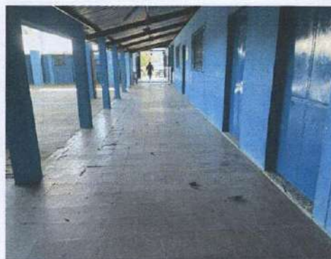
Foto 4: Piso y base de area de corredor en mal estado
