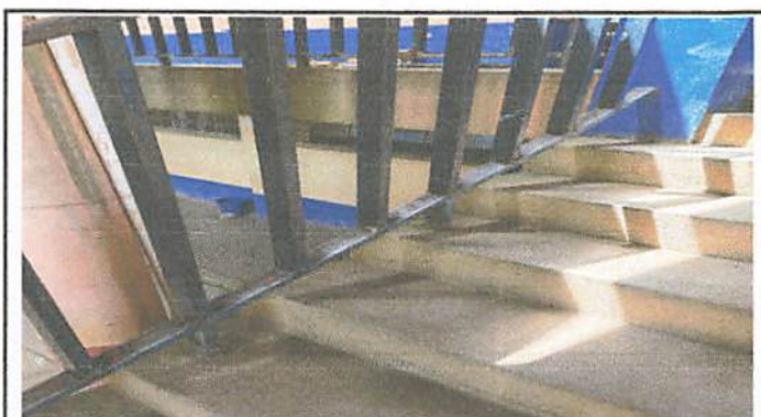
Foto 3: SUSTITUCION DE BARANDA EN GRADAS: BARANDAS EN MAL ESTADO ES NECESARIO PARA LA SEGURIDAD DEL ESTUDIANTE EN ESTE ESTABLECIMIENTO.
