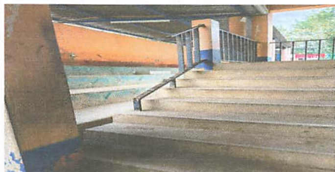
Foto 3: SUSTITUCION DE BARANDA EN GRADAS: BARANDAS EN MAL ESTADO ES NECESARIO PARA LA SEGURIDAD DEL ESTUDIANTE EN ESTE ESTABLECIMIENTO.
