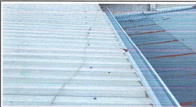
Foto 3: CANALES INSTALADAS EN TECHADO DE CANCHA
