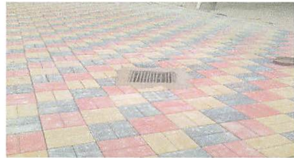
Foto 4: DRENAJE PLUVIAL DONDE SE RECOLECTARA AGUA PLUVIAL
