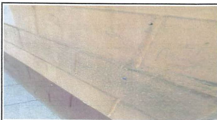
Foto 3: Pintura de las paredes exteriores muy sucias
