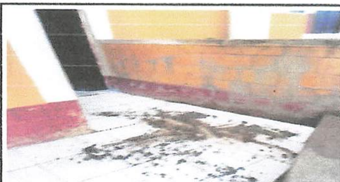
Foto 4: Área del corredor, se torna muy peligroso para caminar, por la falta de la cubierta del techado.
