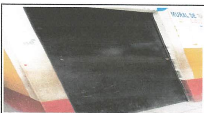
Foto 4: Pintura de las columnas y paredes de las partes exteriores sucias. Despintadas y muy deterioradas.
