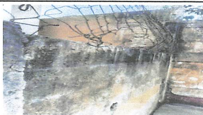
Foto 2: Pared de la parte interna del establecimiento, muro perimetral ya sin pintura muy deteriorada. Sustitución de malla, galvanizada.
