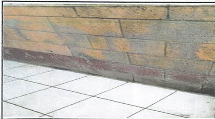
Foto 1: Paredes interiores de la mayoría de las aulas despintadas, sucias, sin pinturas muy desagradables.
