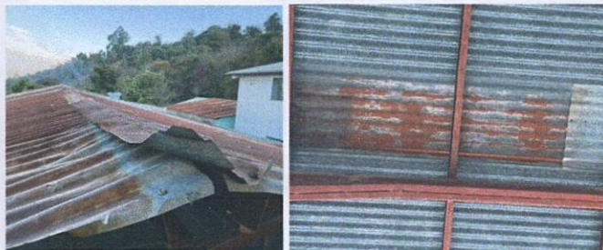
Foto 4: Cubierta de lámina de cancha deteriorada y con filtraciones de agua pluvial
