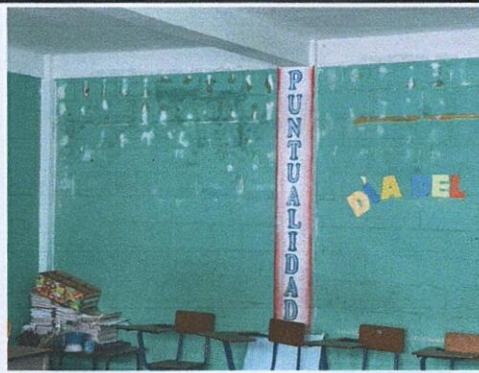
Foto 2: Paredes con problemas de humedad y aparición de hongo
