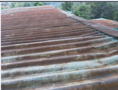
Foto 3: Cubierta de lámina de cancha deteriorada y con filtraciones de agua pluvial
