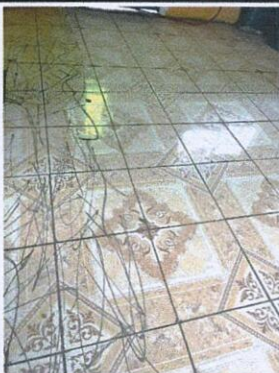
Foto 1: Piso cerámico de cocina en mal estado, ralladuras y deterioro en superficie
