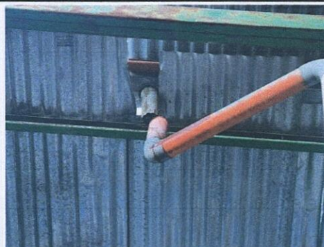
Foto 6: Canales y bajadas de agua pluvial en mal estado
