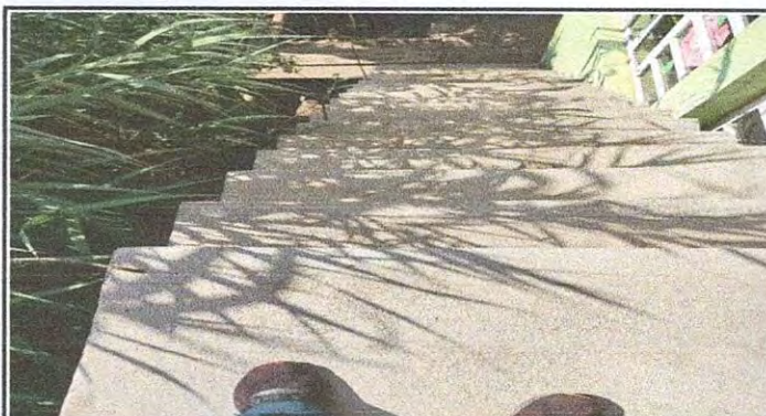
Foto 5: Las gradas de la cocina no cuenta con barandas y es peligrosos para los estudiantes.
