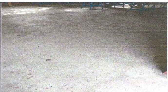
Foto 1.4: En esta fotografía se muestra el salón de tercero básico que no cuenta con piso.
