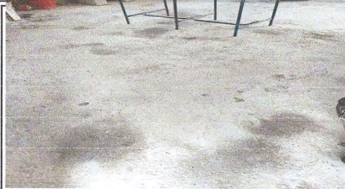
Foto1: Se necesita piso adecuado en el area de cocina.
