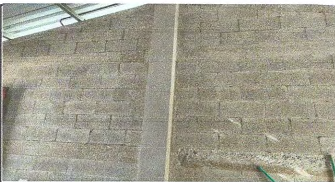
Foto 2: Las paredes de la cocina necesitan cernido en el área interior.
