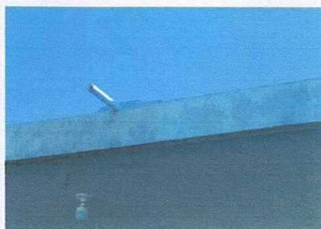
Foto 4: Instalación de tubería provisional por falta de pañuelos o desvinel en losa exterior
