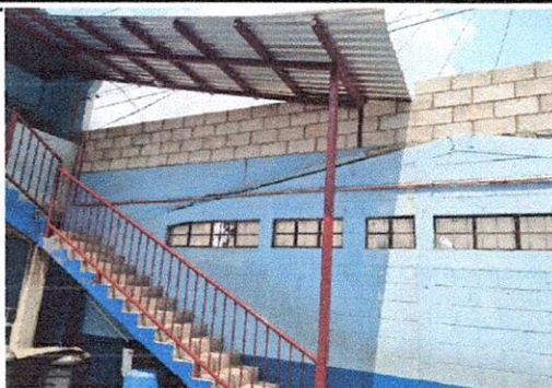
Foto 1: SE NECESITA SUBIR EL NIVEL DE LA PARED YA QUE POR ESA AREA SE METEN LOS LADRONES
