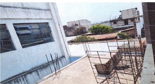
Foto 6: ES NECESARIO SUBIR EL NIVEL DE ESA PARED PARA QUE NO TENGAN COMO ENTRAR A LA ESCUELA
