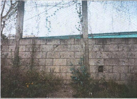
Foto 1: Grietas en lado tarsero del instituto.
